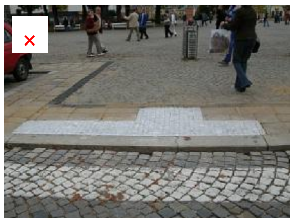
Materiál použitý pro hmatové prvky nevyhovuje nařízení vlády č. 163/2002. Chybí pokračování signálního pásu k vodící linii, chybí vodící linie.
