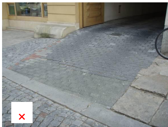
na chodníku není dodržen maximální přípustný příčný sklon 2% (rozpor s vyhl. č. 369/2001 Sb.)
