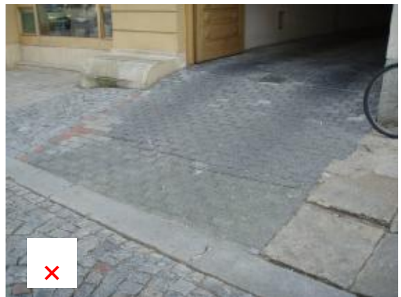
na chodníku není dodržen maximální přípustný příčný sklon 2% (rozpor s vyhl. č. 398/2009 Sb.)
