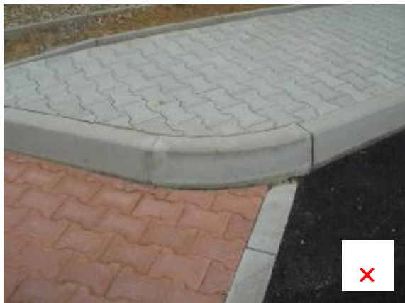
Nevhodné řešení: bariérový chodník bez rampy
