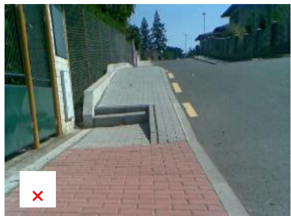
bariérový chodník s vyrovnávacími stupni a s nevyhovující šířkou rampy (cca 40 cm), chybí zábradlí u rampy a varovný pás u vjezdu
